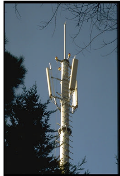
Figura 5. Antenas de una estación base sectorial. A la izquierda una configuración que emplea tres antenas por sector y a la derecha una configuración de una antena por sector.
