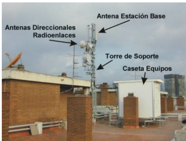
Figura 4 Estación base en una azotea de una zona urbana.
